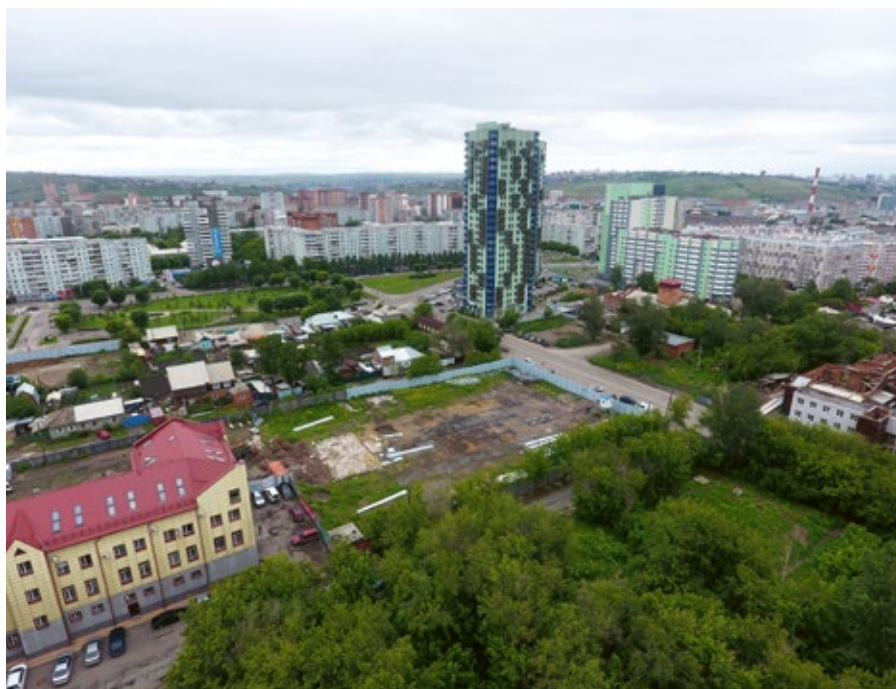
Рис. 2. Аэрофотоснимок, октябрь 2020 года. Вид на строительную площадку с объектом Афонтова Гора V с юго-запада / Fig. 2. Aerial view, October 2020. View of the construction site with the object Afontova Gora V from the southwest.
